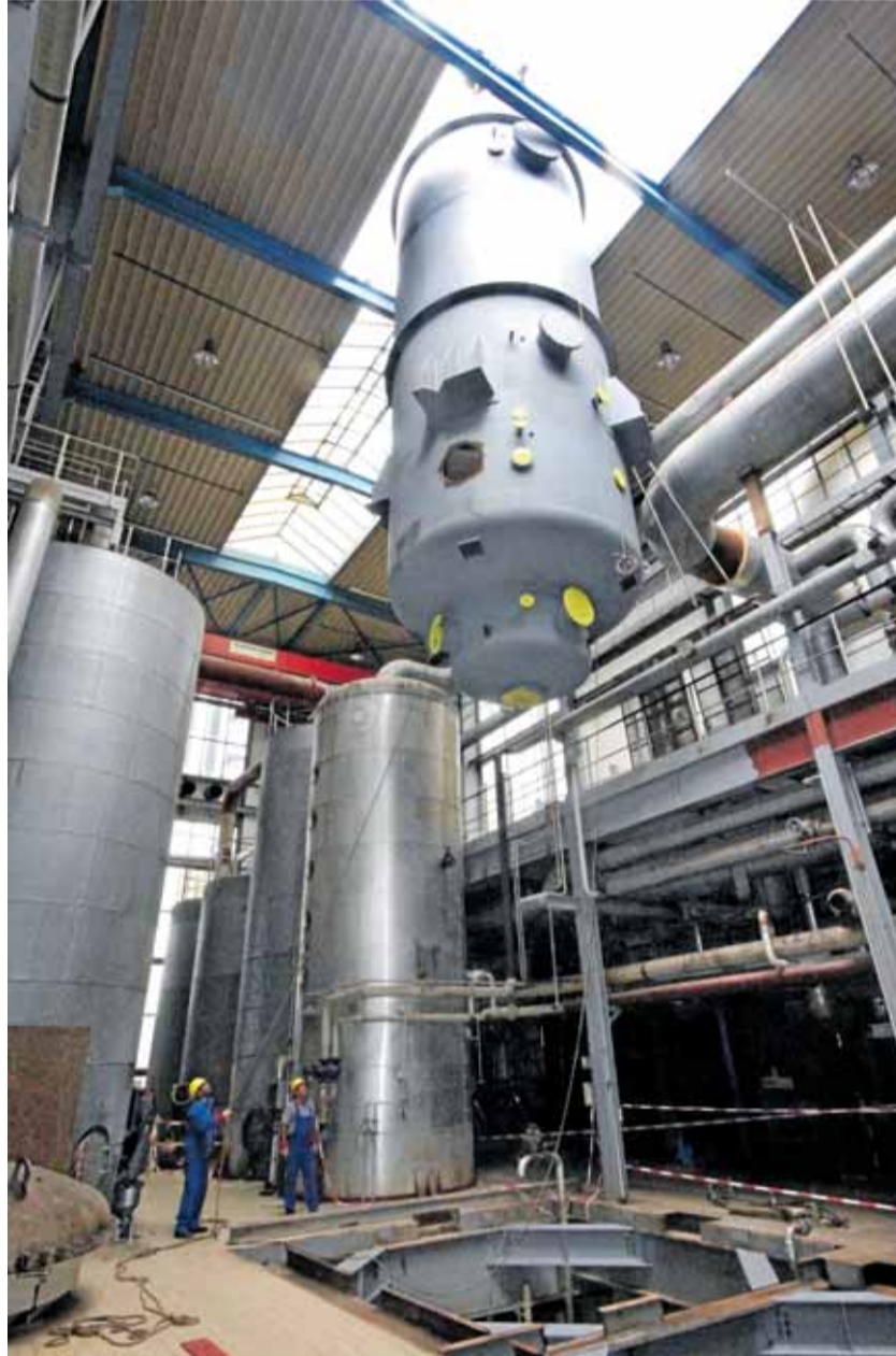
Zentimeter für Zentimeter nähert sich der neue Verdampfer seinem Bestimmungsort in der Halle des Schladener Nordzucker-Werkes. Fotos: Affeldt, Gereke
