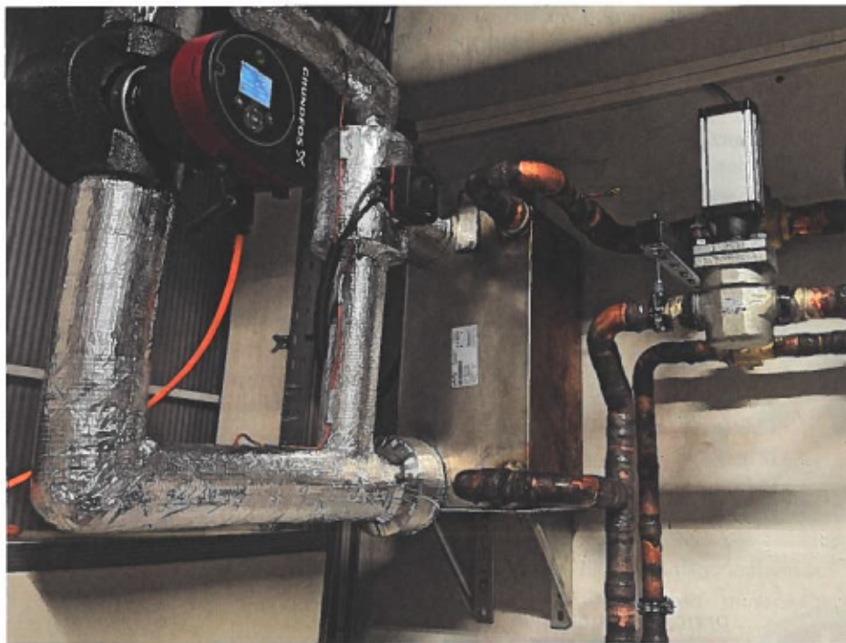
Der Enthitzer bei Linder Backwaren im eingebauten Zustand
